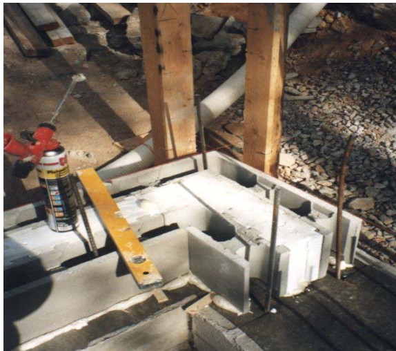
Kuva 2. Kulmatolpat ja linjalanka.
